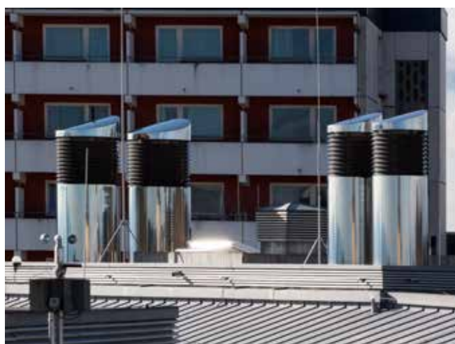
Figura 47 Extracción centralizada por ductos.
