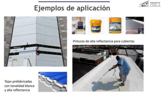
Figura 57. Cubierta de alta reflectancia, elaboración equipo CEELA.
